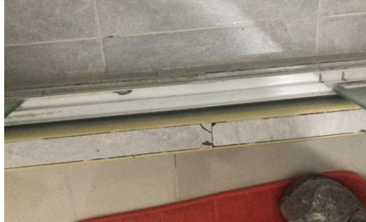
Figura 58. Evidencia poyo en mal estado
