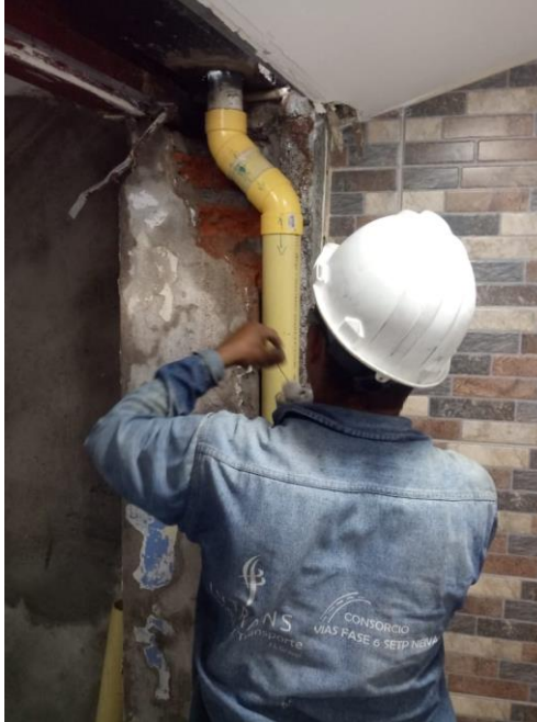
Figura 20. Bajante de aguas en PVC de 3”
