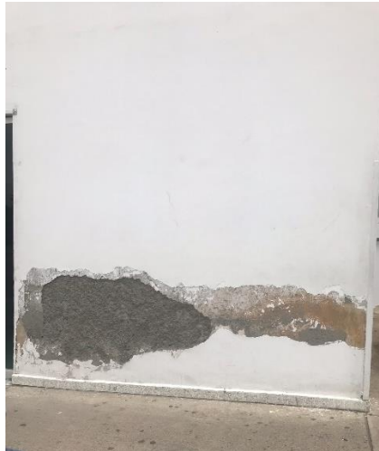
Figura 52. Evidencia deterioro de pintura en fachada
