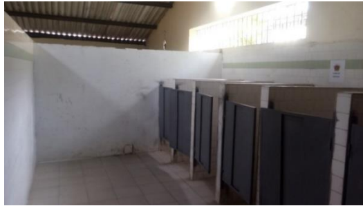
Figura 27. Sección de sanitarios antes del mantenimiento
