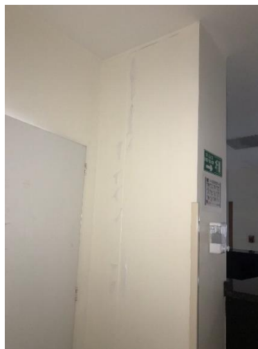
Figura 53. Evidencia deterioro de pintura interna
