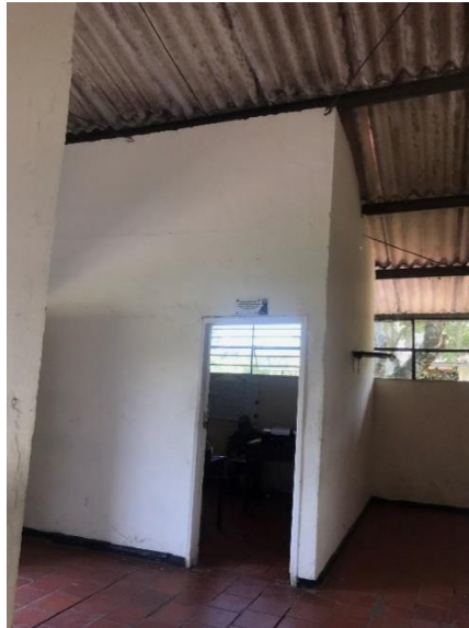
Figura 29. Oficia antes del mantenimiento
