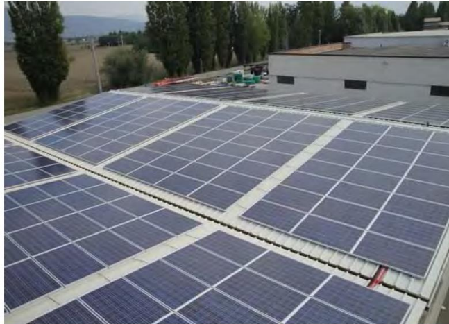
Figura 32: Ejemplo de una planta Solar.
