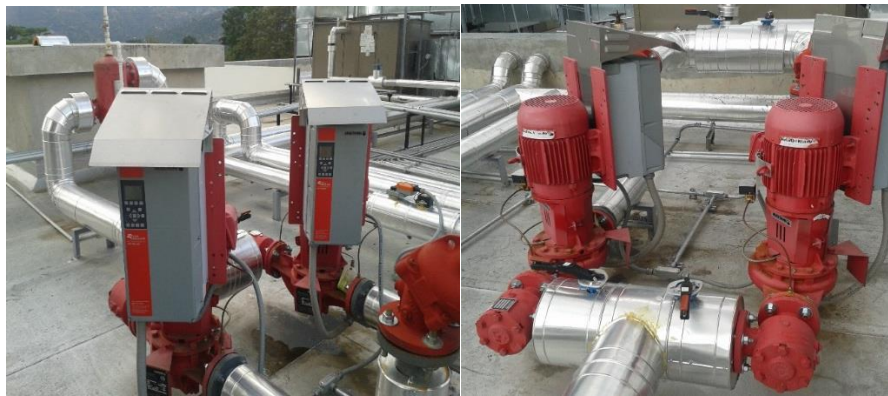
Figura 30: Bombas de recirculación de agua, principal y reserva.
