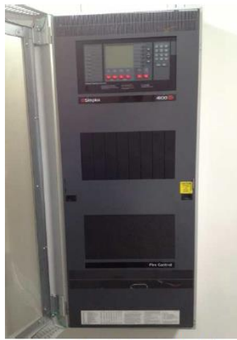
Figura 12: Panel detección de incendio simplex 4100ES [14].
