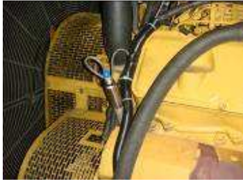
Figura 21 Sensor Vibración B. Izq.
