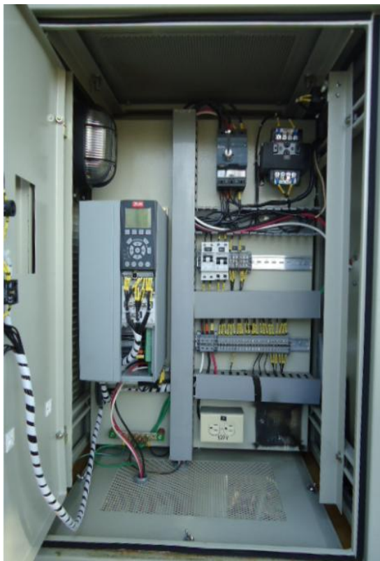
Figura 21: Caja de distribución eléctrica del pozo 33.
