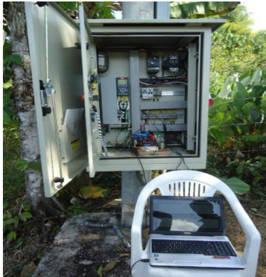
Figura 38: Dispositivo conectado en la caja eléctrica.
