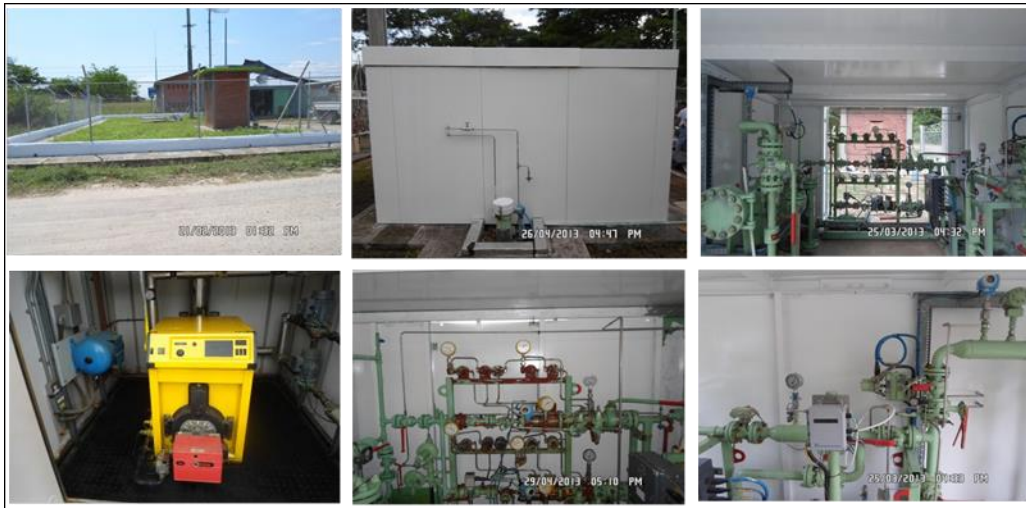
Figura 5. Instalaciones Operativas de TGI, City Gate Saldaña.
