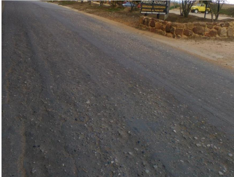
Figura 42. Falla de cabezas duras (CD) presente en el K19+350.
