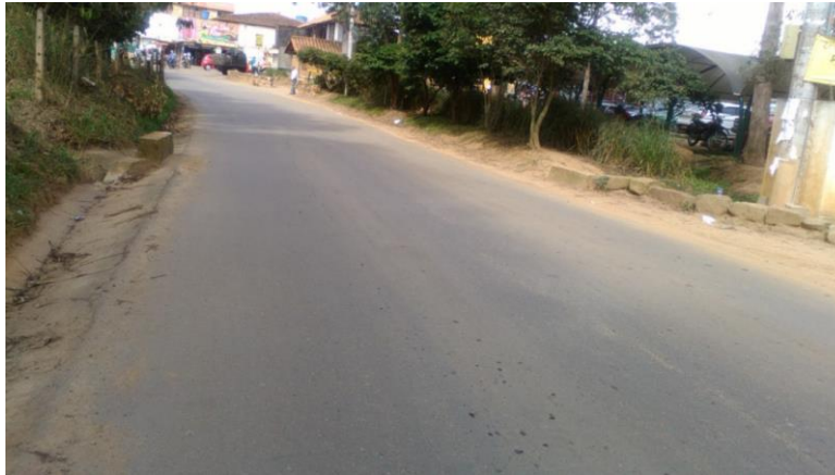
Figura 34. Curva sin señalización – K19+490.
