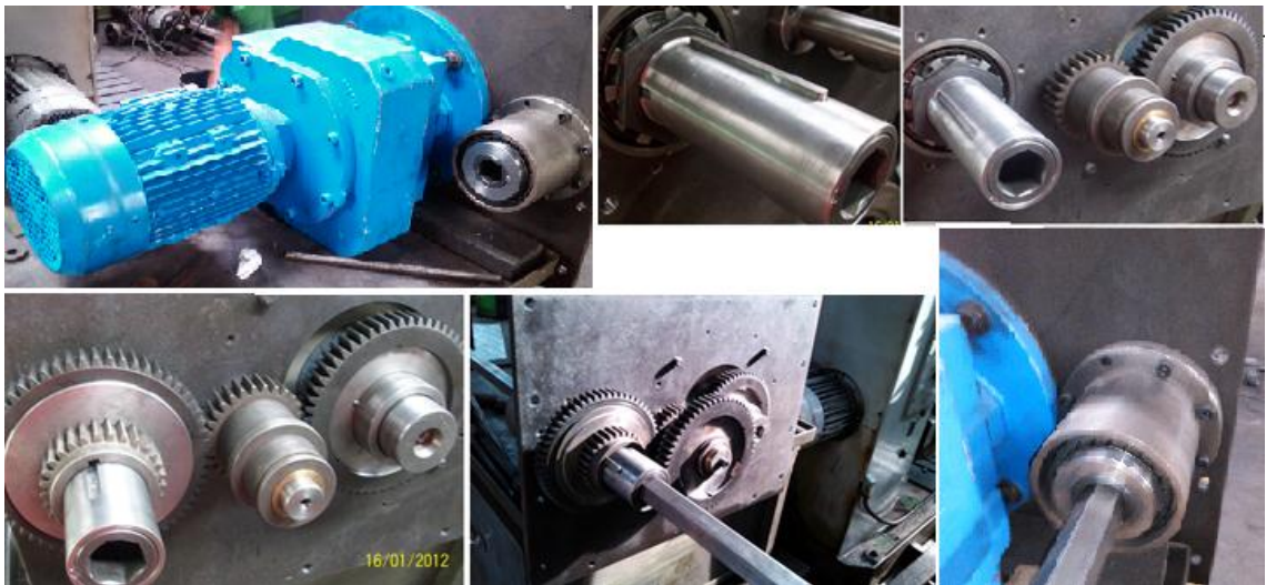
Figura 88. Montaje del sistema de transmisión.
