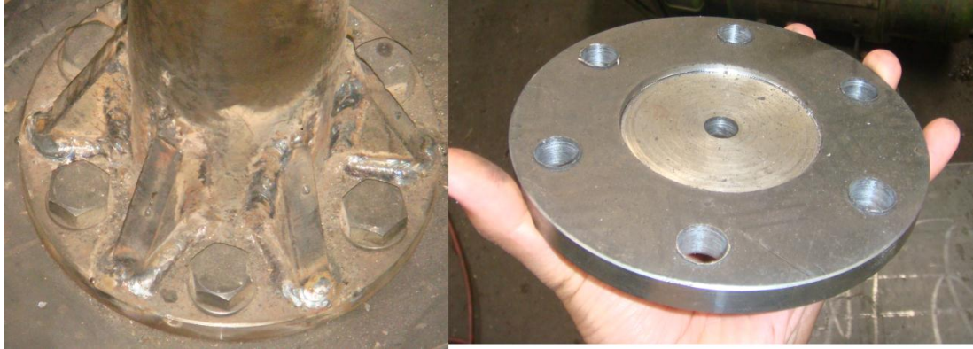
Figura 78. Fotografía de refuerzos y bridas de conexión de la estructura.
