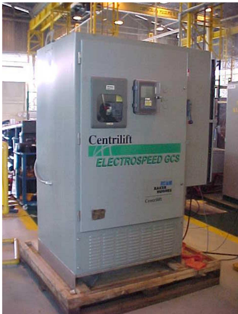
Figura 8. Variador de Frecuencia
