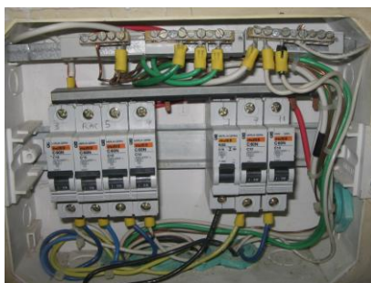
Figura 51. Imagen interna del tablero TCS.
