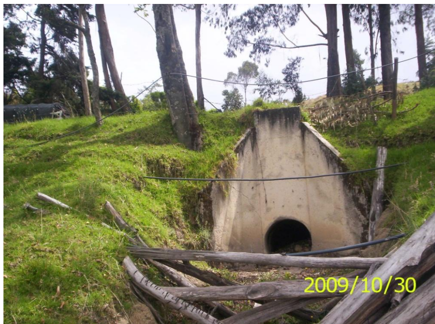
Foto 3: Detalle alcantarilla colapsada por el movimiento del talud. Esta obra debe clausurarse llevando las aguas lluvias de la vía a la siguiente.
