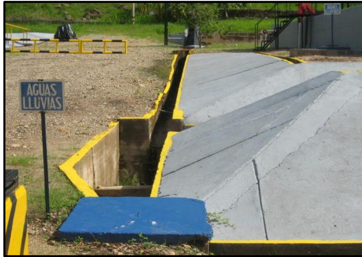
Figura 38. Sistema de drenaje de aguas lluvias
