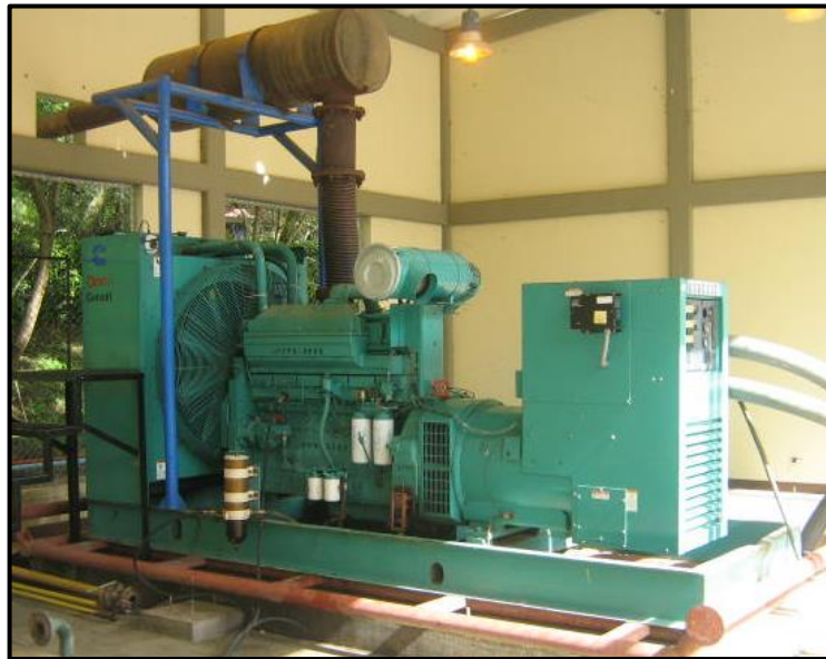
Figura 40. Generador de emergencia a diésel K-19
