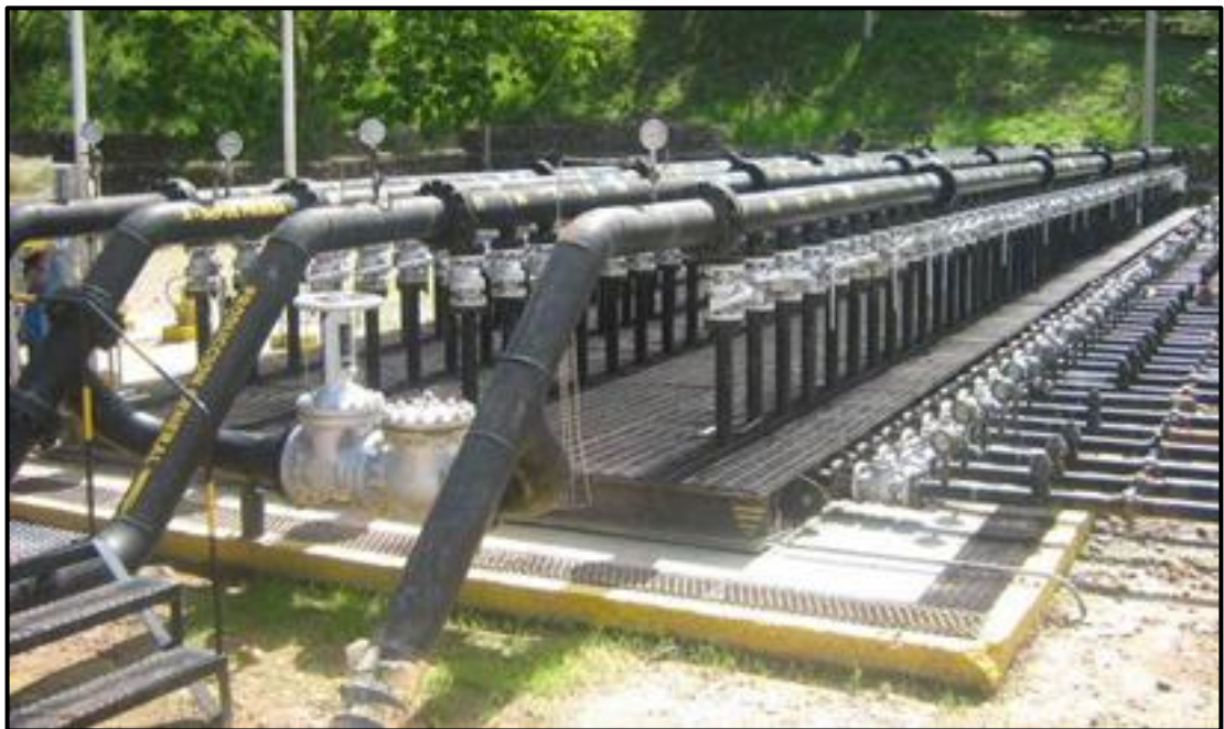
Fotografía 1. Colectores de Producción y Prueba (ANSI 300)
