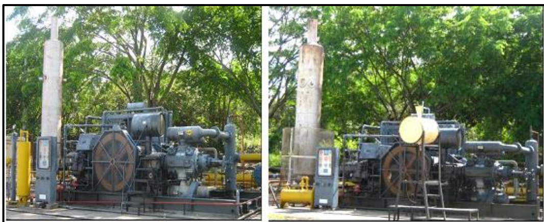
Fotografía 12. Sistema de Compresión de Gas
