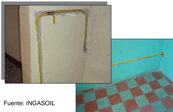
Figura 5. Instalaciones Internas con PE-AL-PE
