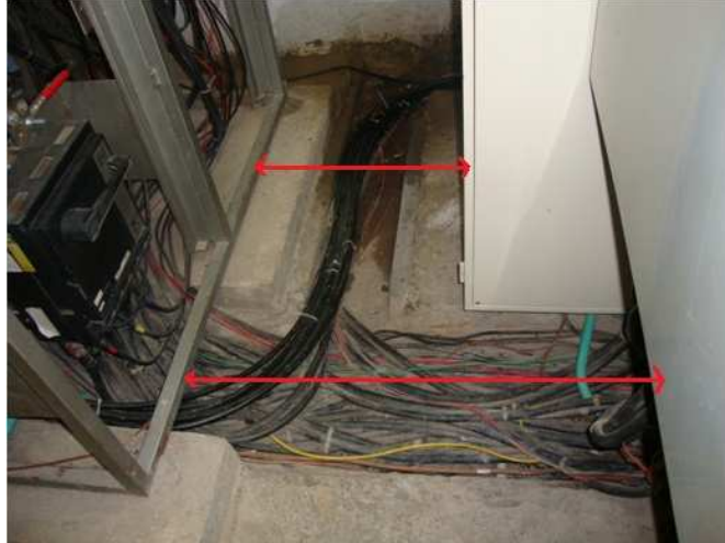
Figura 83. Irregularidades del TG subestación 1
