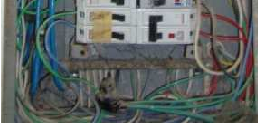
Figura 90. Tablero sin barraje independiente de tierra
