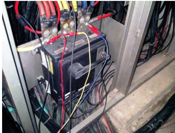
Figura 102. Conexion de analizador de redes al interruptor general
