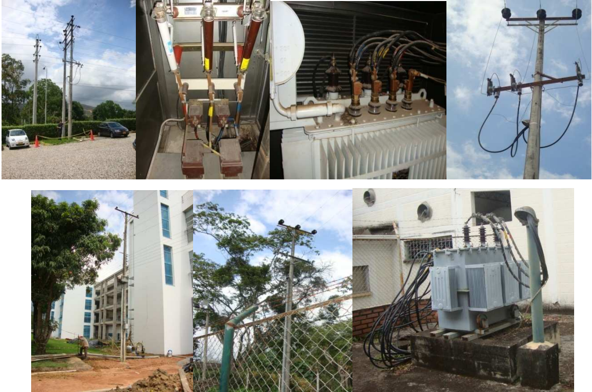
Figura 6. Imágenes de recorrido de la alimentación de la subestación 1.
