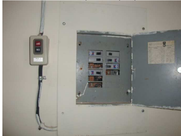
Figura 84. Tablero sin señalización que indique presencia de riesgo eléctrico.
