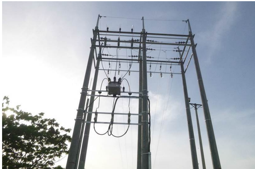
Fotografía 7. Portico media tensión.
