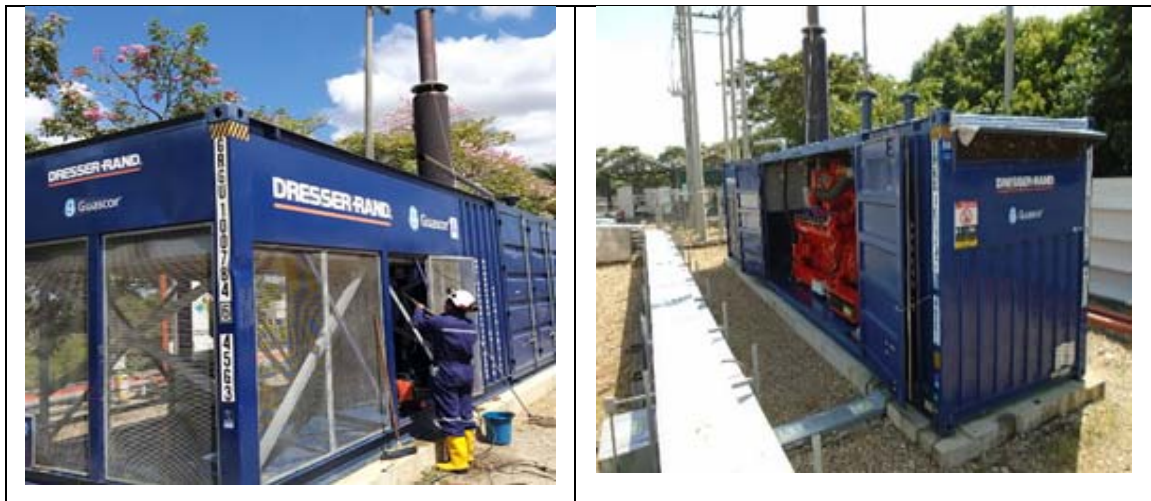
Fotografía 4. Unidades cabinadas del sistema de generación.
