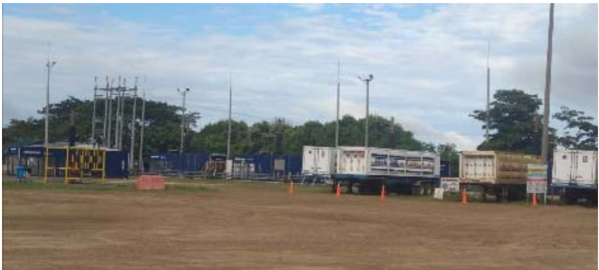
Fotografía 3. Panorámica de zona de generadores
