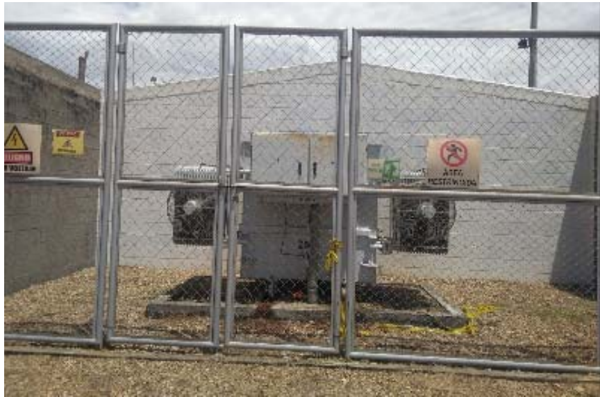
Fotografía 6. Transformador media tensión 2500 kVA.
