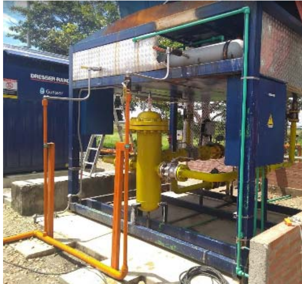
Fotografía 2. Estación reductora de presión PRP
