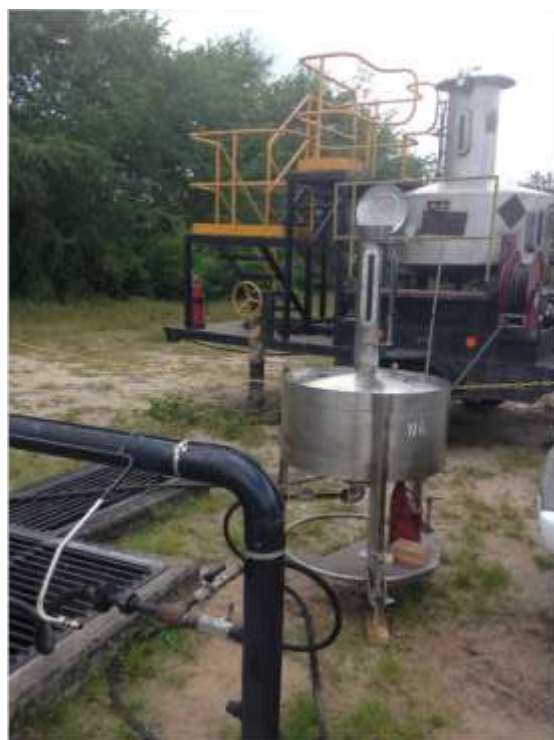
Fotografía 8. Conexión típica, realizada en cabeza de pozo.
