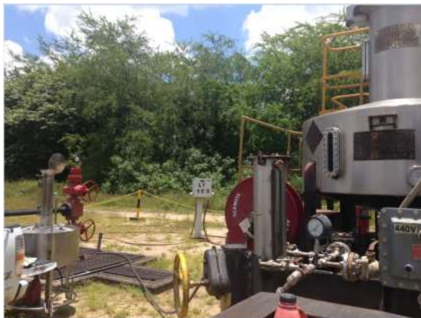
Fotografía 7. Pozo LY-169, Prueba comparativa de los tanques de prueba de 50 galones y el de 420 galones.
