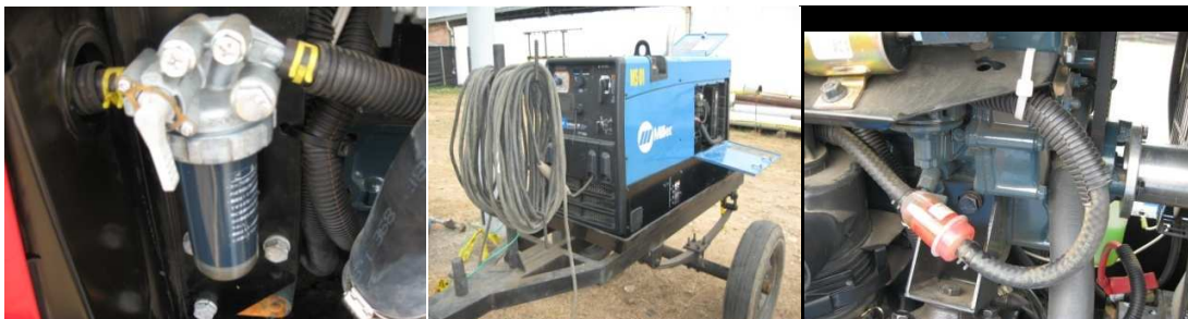
Figura 15. Filtro de combustible, Tanque, Cedazo de combustible en línea.
