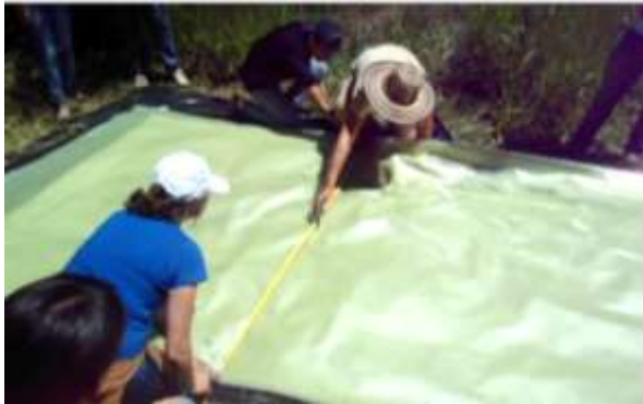
Ubicación de la salida del biogás
