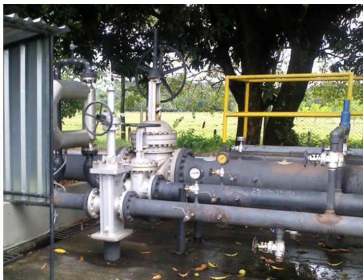
Figura 26. Múltiple o manifold de Campo Castilla
