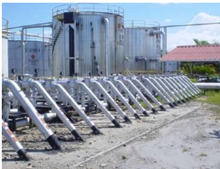
Figura 9. Manifold de entrada en la Estación Castilla 2
