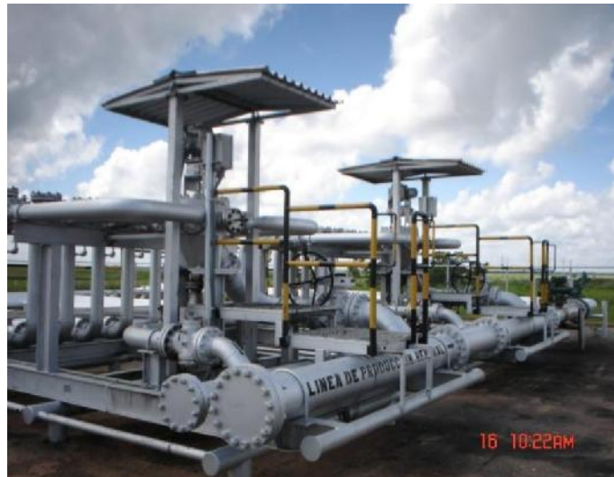
Figura 20. Válvula selectora Multipuerto sobre skid
