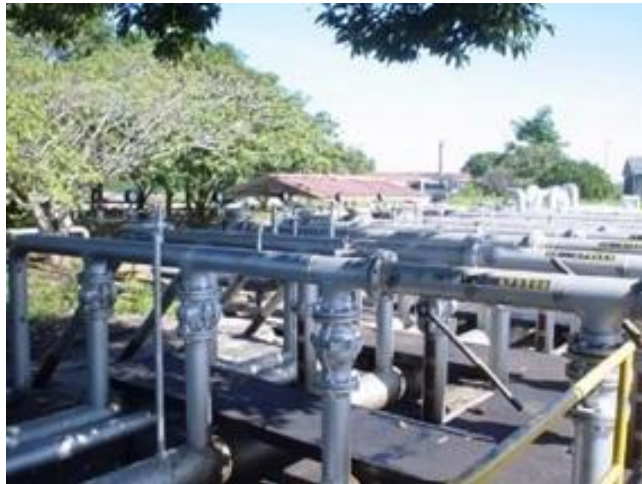
Figura 7. Manifold de entrada en la Estación Castilla 1
