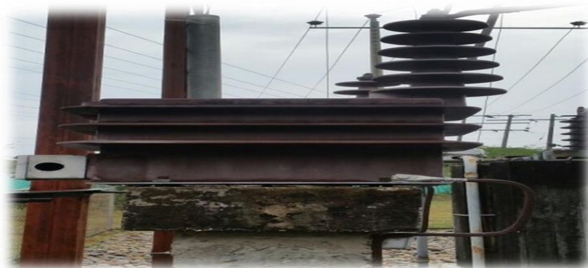
Figura 13. Transformador de medida tensión PT
