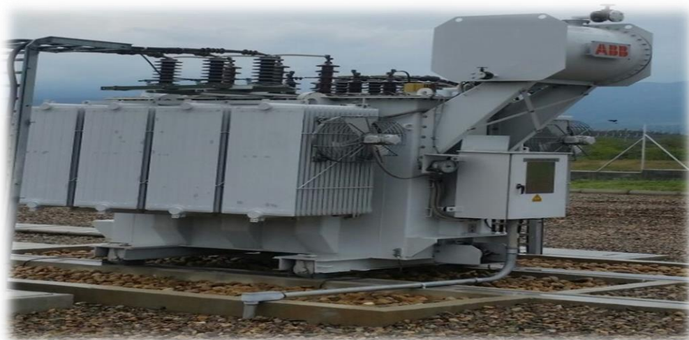
Figura 9. Transformador de potencia 34.5 kV/13.8 kV
