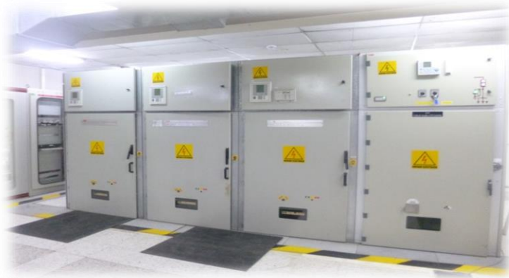
Figura 17. Bahías Circuito de celda
