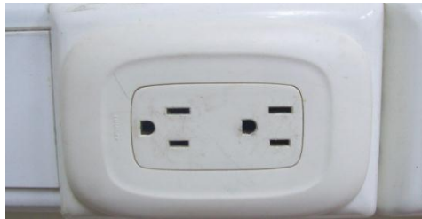
Figura 80. Buen estado del tomacorriente
