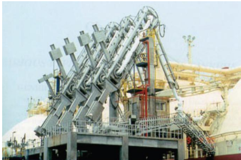
Figura 4. Brazos de descarga de GNL a tanques.
