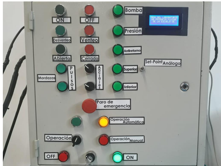
Figura 4. Módulo de control (Estado final)
