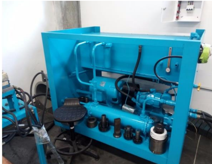
Figura 1. Módulo de potencia (Estado inicial).
