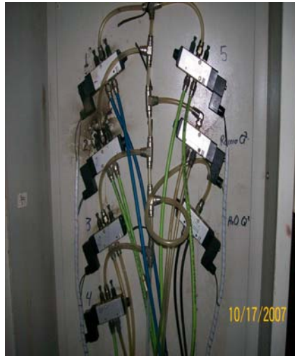
Figura N° 17 Tableros de distribución neumática
