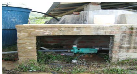
Figura N° 41 Motobomba tanques de tratamiento granja Caciquito
