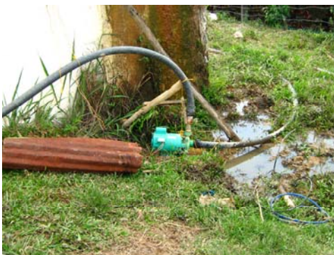
Figura N° 75 Motobomba tanques de distribución granja el Topón
