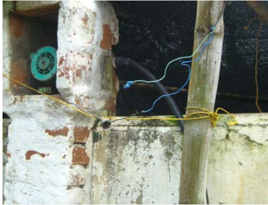
Figura N° 71 Acometida eléctrica bomba de tratamiento granja villa Juanita
