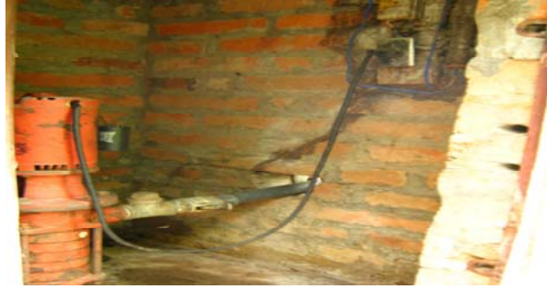
Figura N° 97 Motobomba tanques de tratamiento granja Los Laureles
