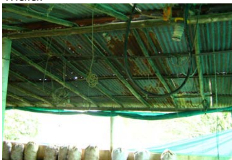
Figura N° 87 Acometida eléctrica interna de galpón granja La Luciérnaga
