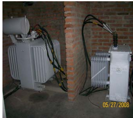
Figura N° 49. Transformadores 315 KVA a 440 Voltios.
