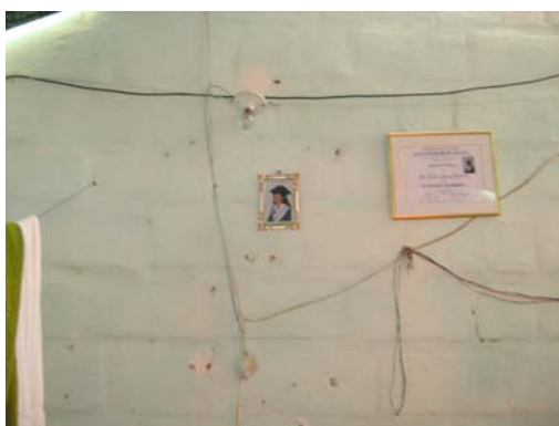
Figura N° 65 Acometida eléctrica casa galponero Andalucía
