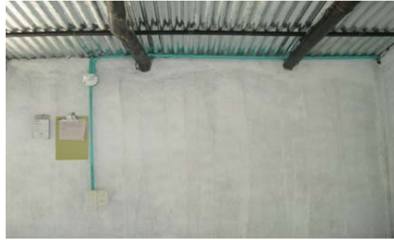
Figura N° 42 Acometida eléctrica casa Caciquito
