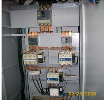
Figura N° 47. Tablero 440 Voltios cuarto de control.
