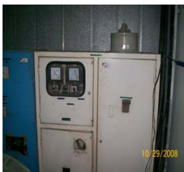
Figura N° 52. Tableros subestación planta de incubación.
