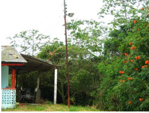
Figura N° 44 Acometida eléctrica a casa granja San Nicolás
