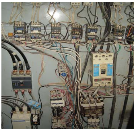
Figura N° 9 Acometida eléctrica 440 – 200 Voltios zona de recepción de materia prima
