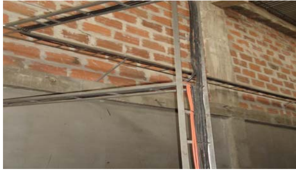
Figura N° 26 Acometida eléctrica horno maquina de bandejas 1
