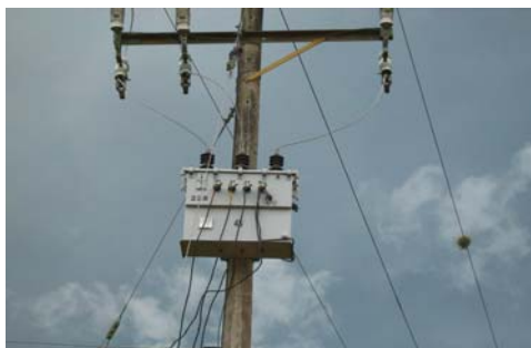
Figura N° 43 Acometida eléctrica a granja San Nicolás
