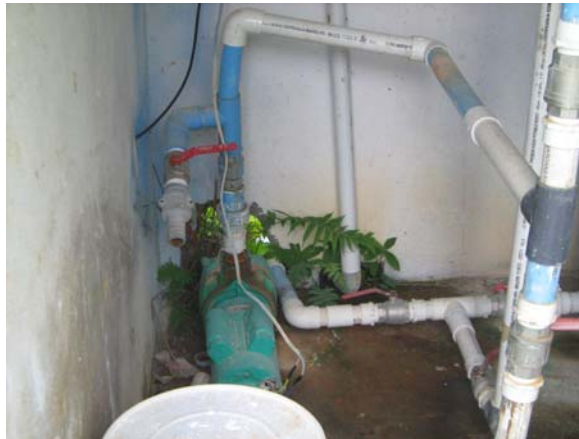
Figura N° 62 Motobomba tanques de tratamiento granja San Antonio
