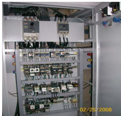
Figura N° 48. Tablero 220 Voltios cuarto de control.
