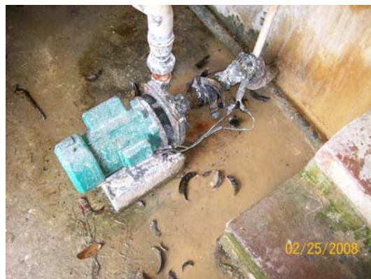
Figura N° 78 Bomba tanques de distribución granja Abedul
