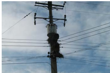
Figura N° 55. Transformador granja Santa María.
