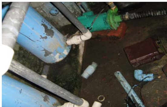
Figura N° 84 Motobomba tanques de distribución granja Villa María
