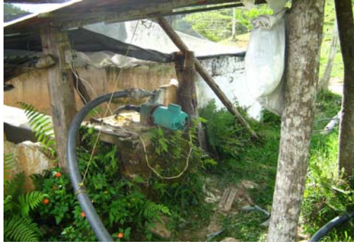
Figura N° 88 Acometida eléctrica motobomba lago granja La Luciérnaga
