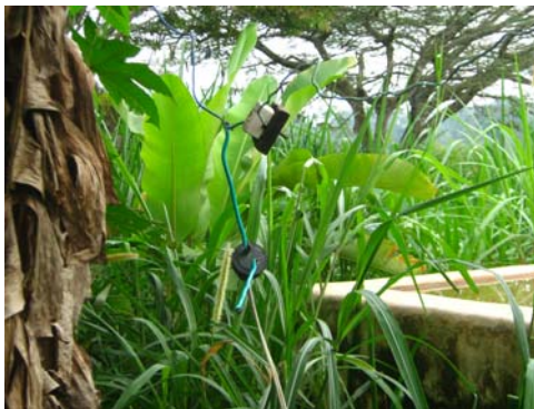
Figura N° 73 Acometida eléctrica bomba de lago granja villa Juanita
