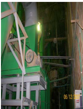
Figura N° 15 Acometida eléctrica planta de frijol soya
