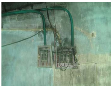
Figura N° 33 Acometida eléctrica casa Villa Luz
