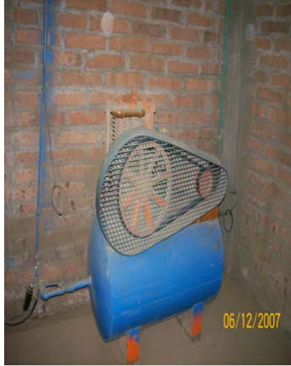
Figura N° 16 Compresor planta de frijol soya
