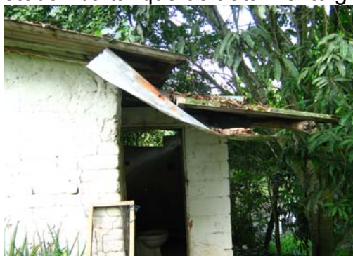
Figura N° 68 Estado de techo galpones granja Villa María
