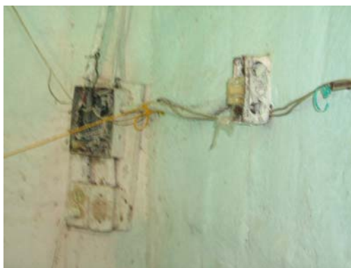
Figura N° 64 Acometida eléctrica a galpones granja Andalucía
