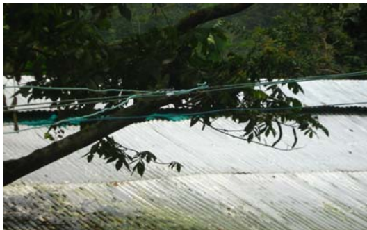
Figura N° 72 Acometida eléctrica a galpones granja villa Juanita
