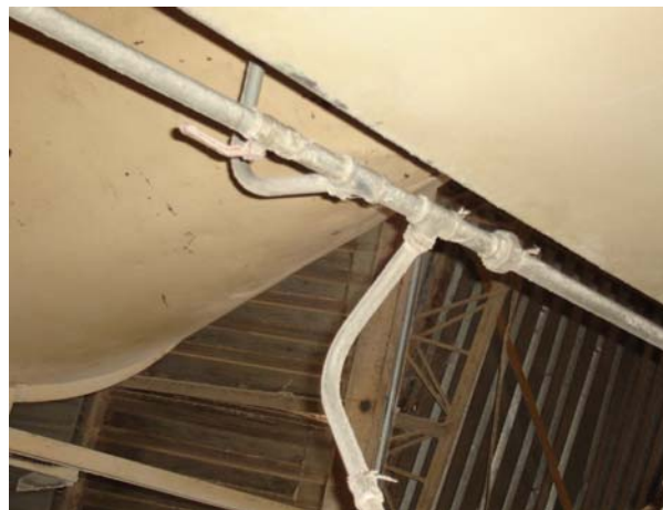
Figura N° 12 Línea neumática tolva báscula
