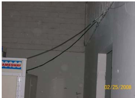
Figura N° 22 Acometida eléctrica a nacedoras Jamesway
