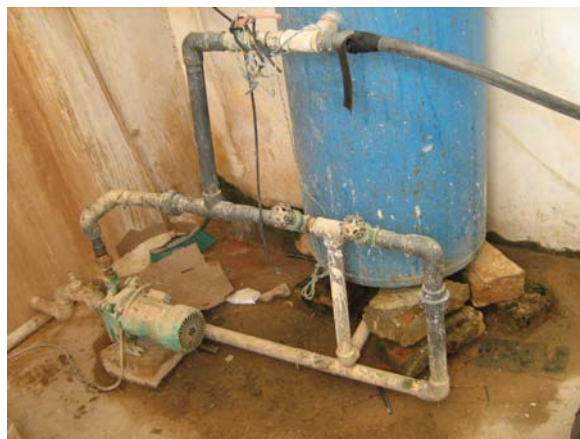
Figura N° 80 Motobomba tanques de distribución granja Villa Rosario
