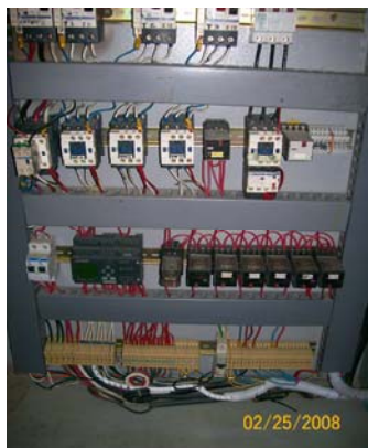
Figura N° 50. Tablero de potencia cookers.
