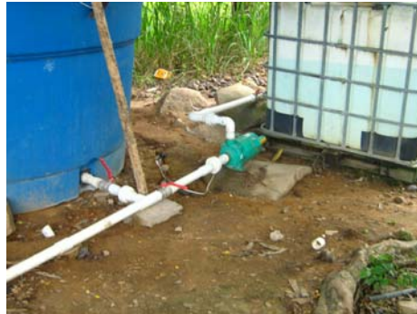
Figura N° 69 Motobomba tanques de tratamiento granja Villa Inés
