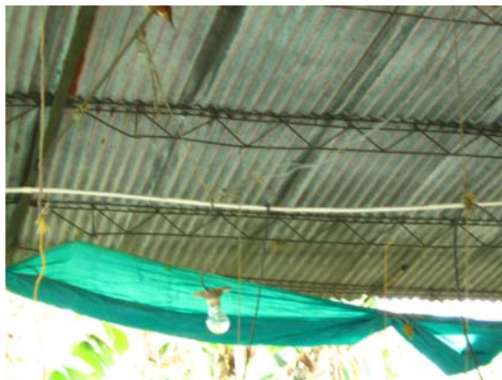
Figura N° 91 Acometida eléctrica interna galpón granja El Capricho
