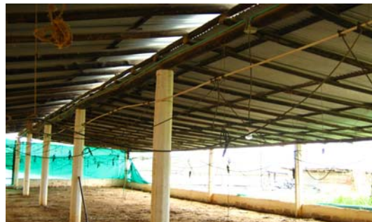
Figura N° 96 Acometida eléctrica galpón 2 granja Acrópolis
