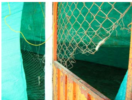
Figura N° 83 Estado de puerta entrada a galpón granja Villa Berta
