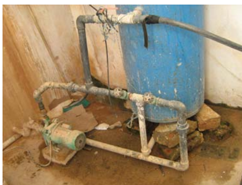
Figura N° 67 Motobomba tanque de tratamiento granja Villa María
