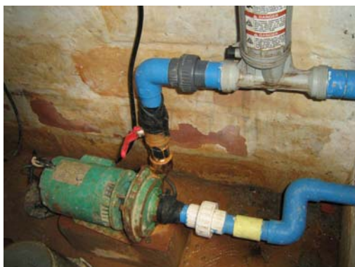
Figura N° 66 Motobomba tanque de distribución granja Santa María
