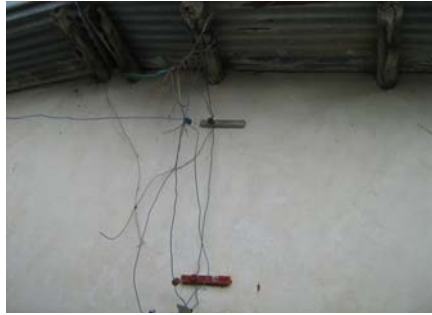
Figura N° 36 Acometida eléctrica a galpón Granja El portal
