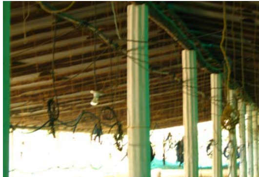
Figura N° 95 Acometida eléctrica interna galpón 1 granja Acrópolis
