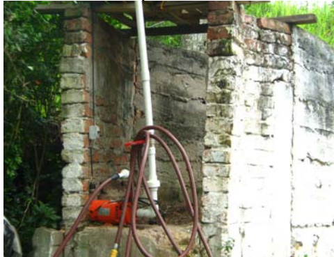
Figura N° 70 Motobomba tanques de distribución granja Villa Inés
