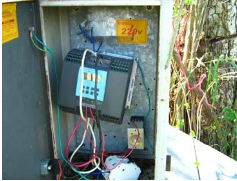
Figura N° 31 Variador de velocidad motobomba Santa Luisa
