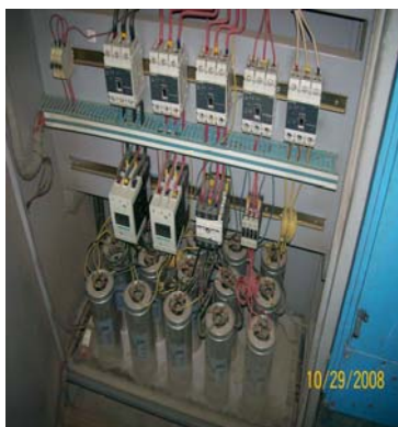
Figura N° 51. Tablero banco de condensadores planta de incubación.
