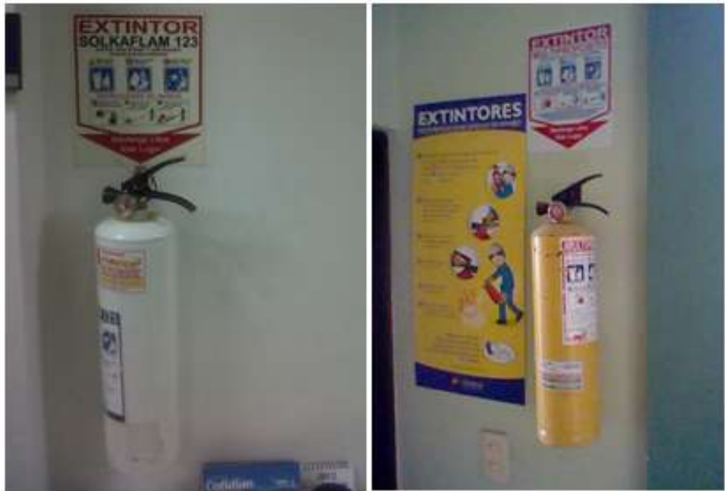
Imagen 11. Identificación y señalización de extintores
