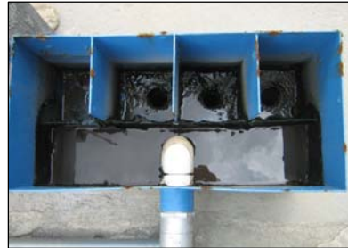
Figura A4. Caja de Reparto.
