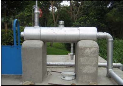
Figura A6. Sistema de limpieza y quemado del gas.
