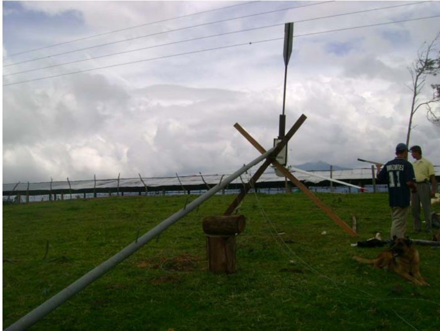
Figura 67. SICOE instalado en la Torre
