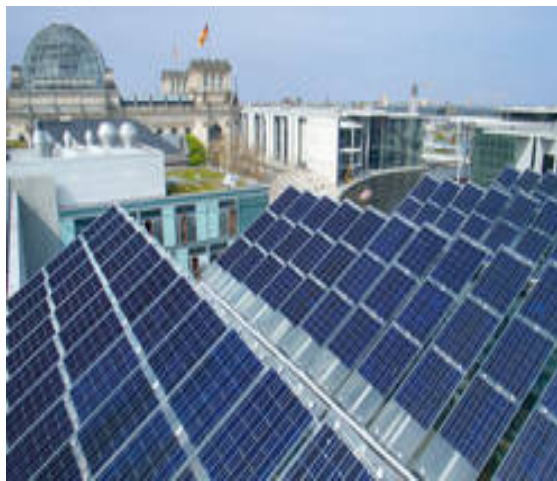
Figura 5. Instalación fotovoltaica en el barrio gubernamental de Berlín. www.randbenergy.com
