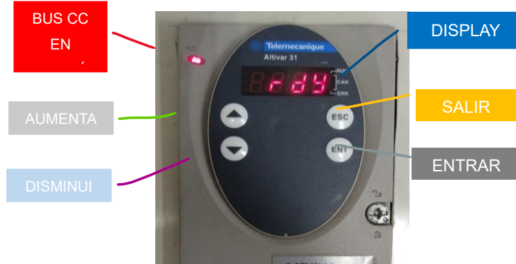
Figura 52. Reconocimiento del Display del variador.
