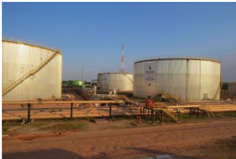
Figura 8. Tanques de Almacenamiento
