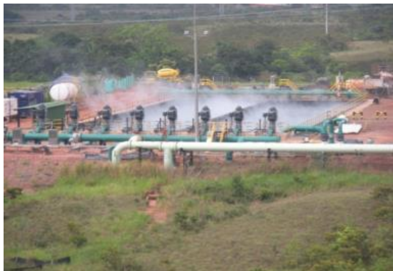
Figura 12. Piscinas de Inyección
