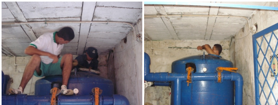
Fotografía 7. Mantenimiento filtro de piscinas.
