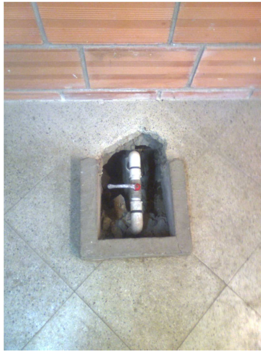
Figura 11 Válvula de bola para el llenado del tanque subterráneo
