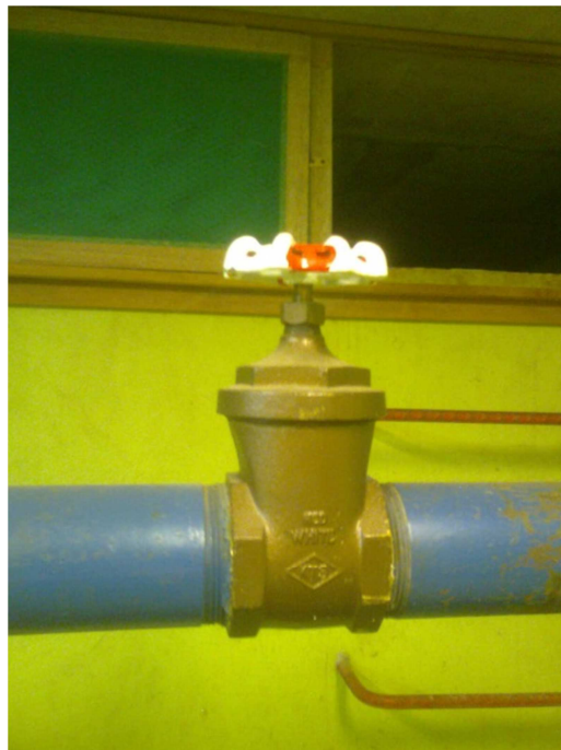
Figura 7 Válvula de compuerta conectada a la tubería para el purgado del tanque subterráneo
