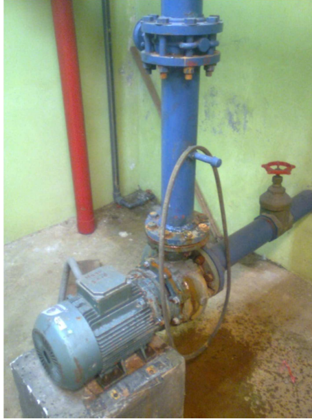
Figura 2 Bomba Siemens 9 HP No. 1
