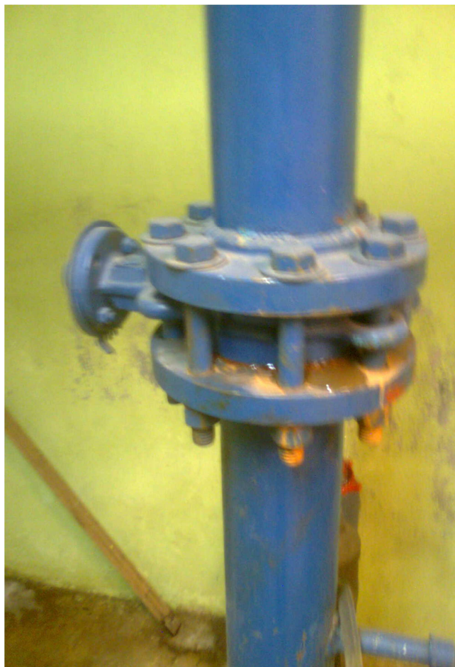
Figura 9 Válvula de mariposa 1 tubería de impulsión
