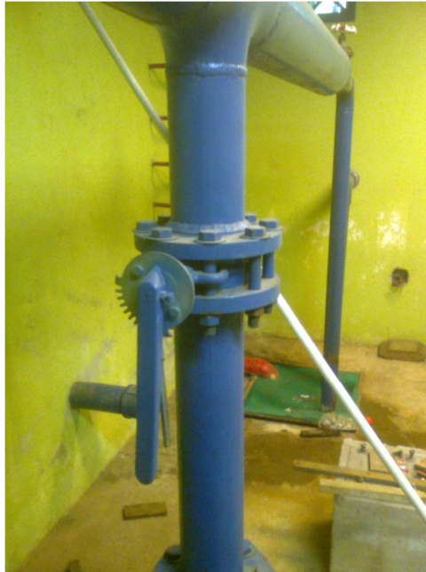
Figura 10 Válvula de mariposa 2 tubería de impulsión
