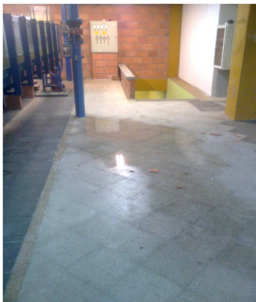
Figura 29 Inundación parcial del laboratorio por averías en el techo
