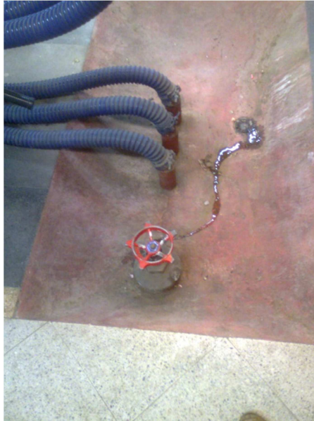
Figura 8 Válvula de compuerta para el canal de pendiente variable
