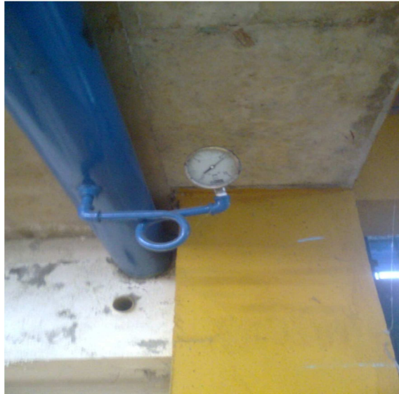
Figura 19 Manómetro tubería conducción
