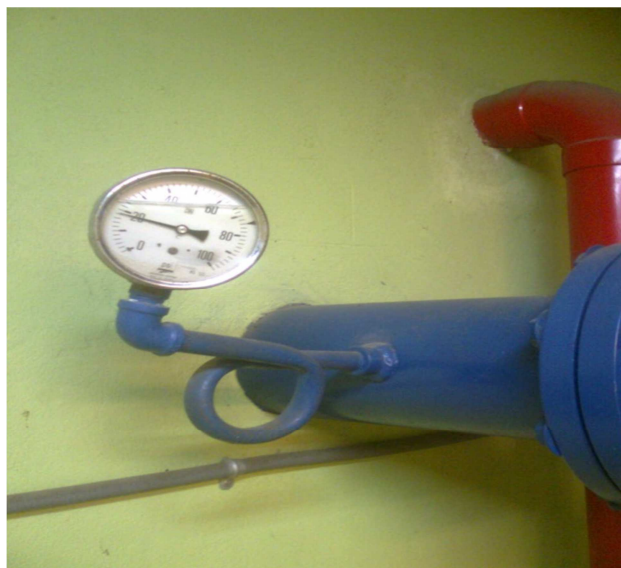
Figura 18 Manómetro tubería impulsión
