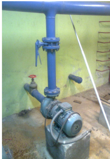
Figura 3 Bomba Siemens 9 HP No. 2
