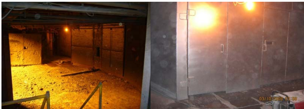
Figura 26. Confinamiento chimenea convertidores
