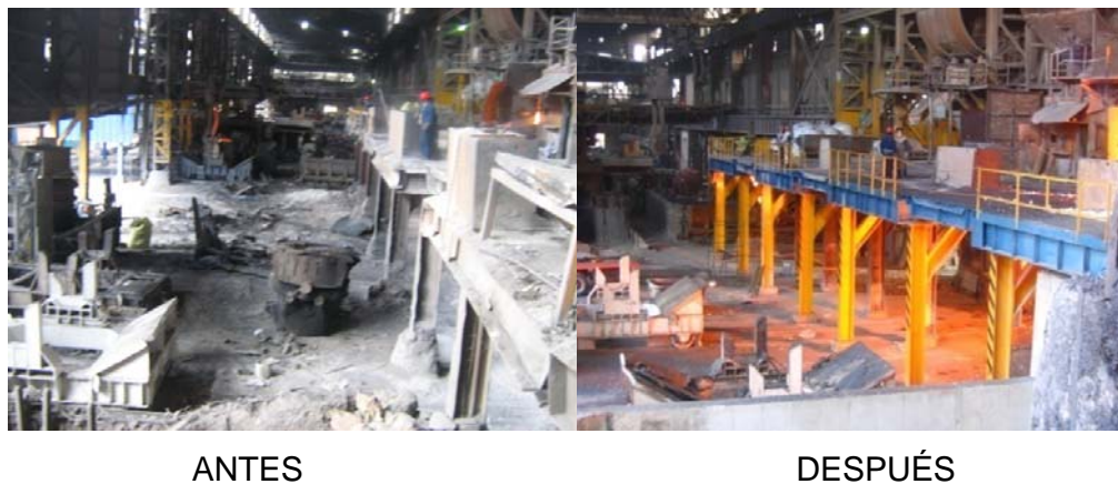
Figura 20. Plataforma segundo nivel convertidores.
