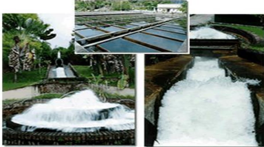
Figura 47. Planta de Tratamiento La Flora
