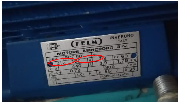
Figura 3. Ficha técnica motor asíncrono. Foto tomada en los laboratorios de la Escuela de Ingeniería Mecánica.
