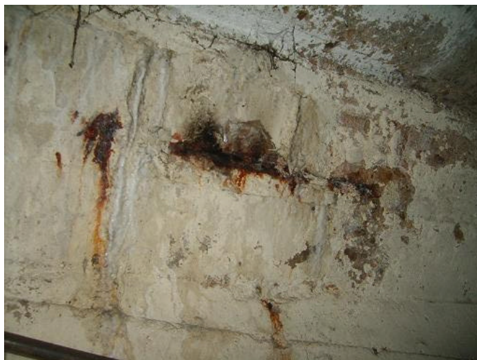
Figura 58. Fisuras por oxidación del acero de refuerzo.
