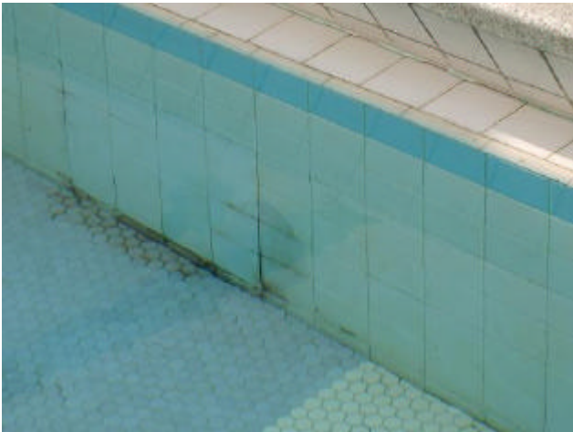
Figura 52. Mancha en muro norte (A).
