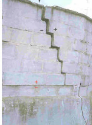
Figura 29. Desplazamiento de la parte superior del muro de contención ejecutado con bloques.
