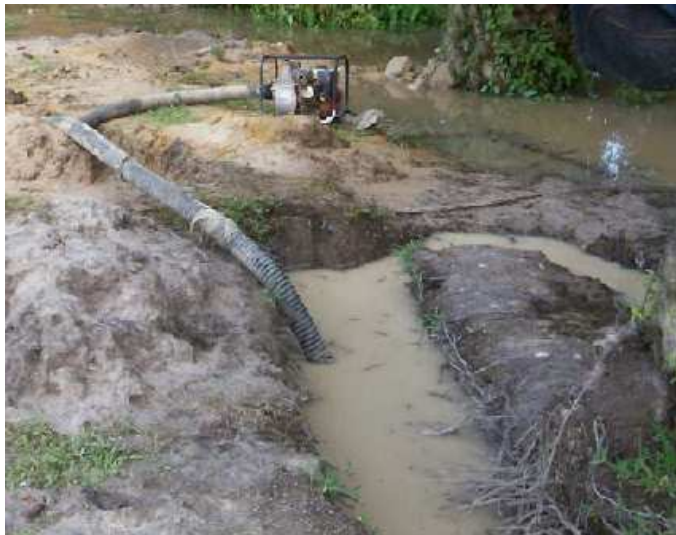
Figura 13. Inundación en Zanjas
