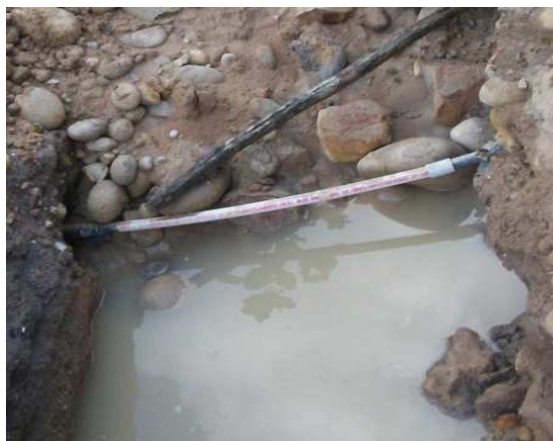
Figura 15. Interferencia con Tuberías de Agua
