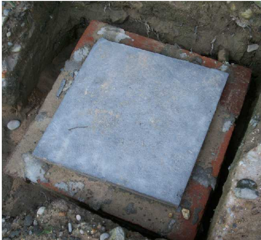
Figura 11. Caja de Inspección
