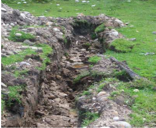
Figura 14. Deslizamientos de paredes en zanjas
