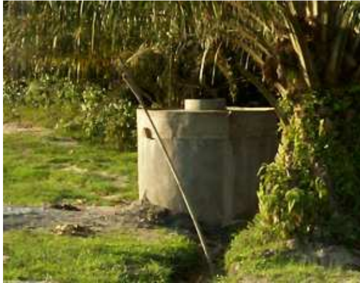
Figura 10. Pozo de Inspección en zona inundable.
