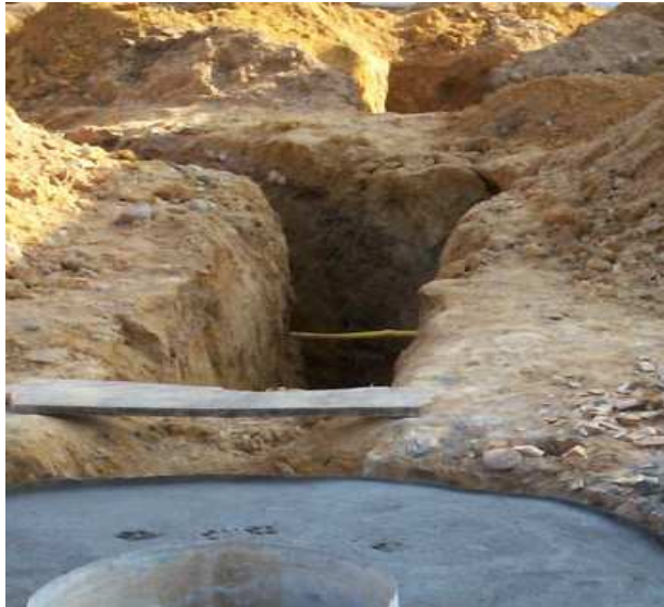
Figura 16. Interferencia con tuberías de gas
