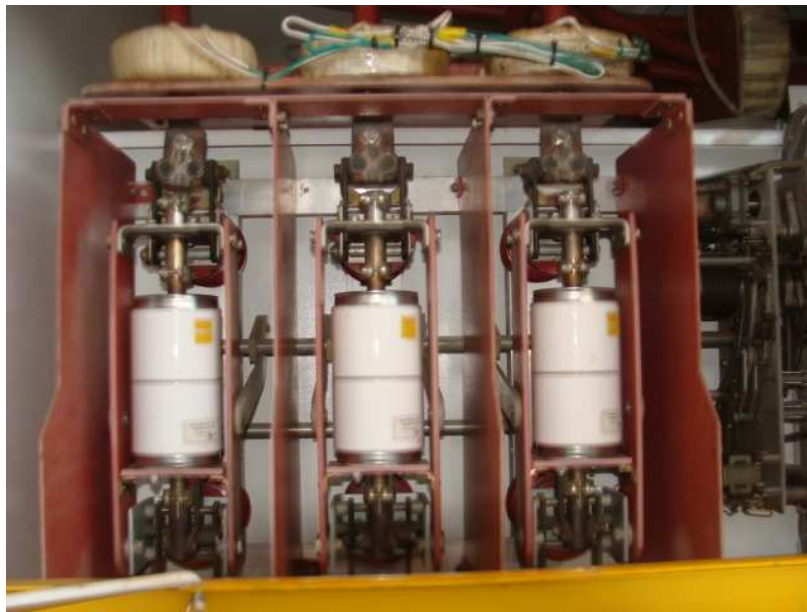
Figura 24. Vista de las botellas de vacío de los interruptores de las subestaciones portátiles en Cerrejón
