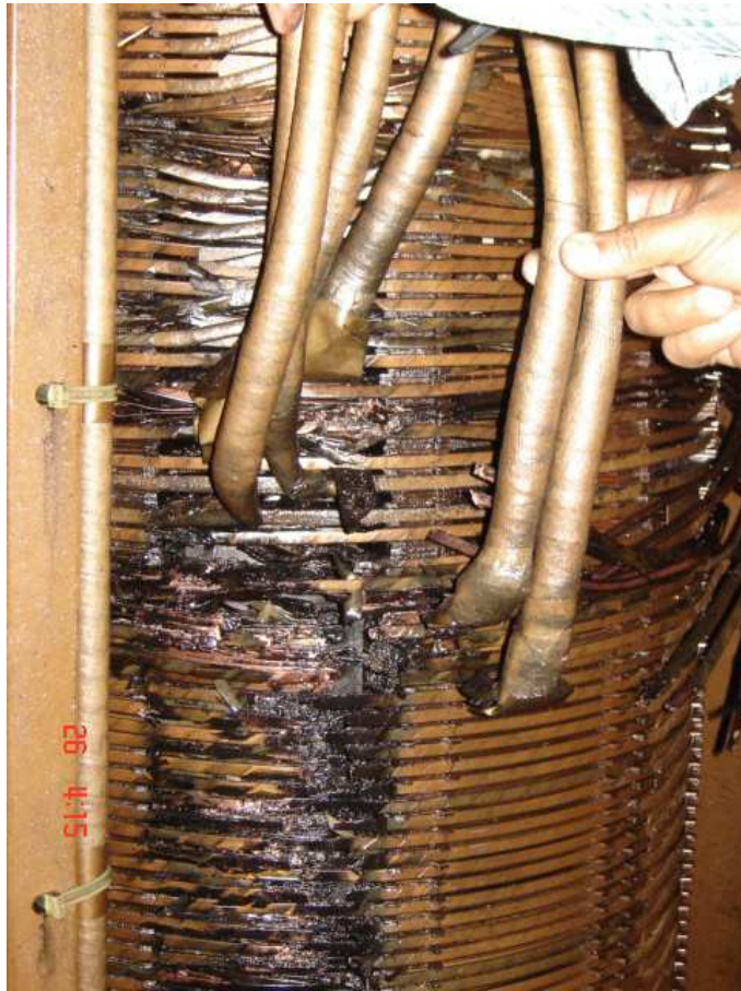
Figura 20. Falla en la bobina H1-H2 subestación 222
