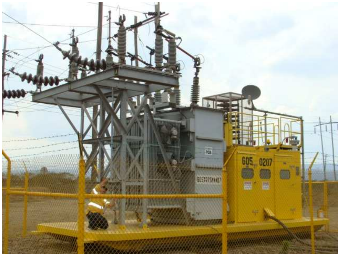
Figura 11. Subestación portátil de 10,5 MVA, 69 kV / 7,2 kV
