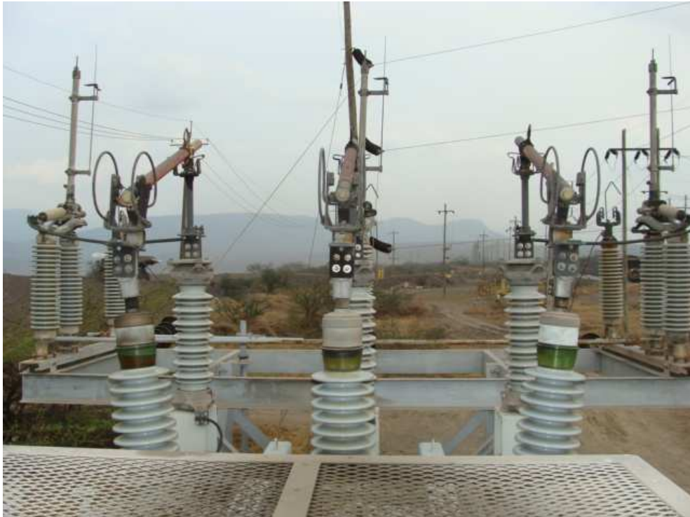
Figura 12. Protecciones contra sobrecorriente del transformador
