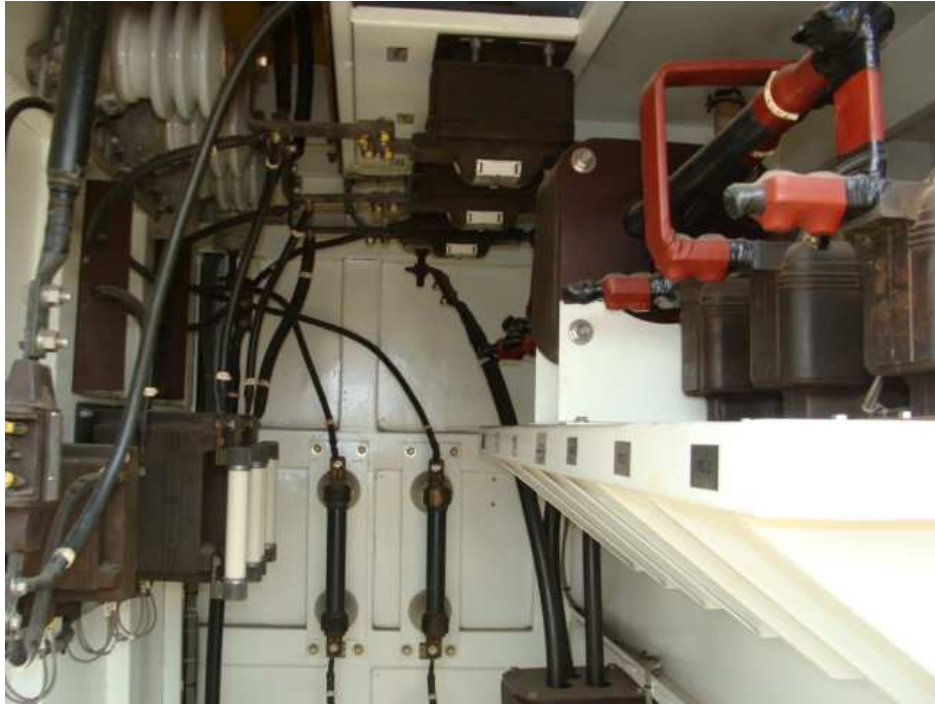
Figura 14. Cubículo de potencia
