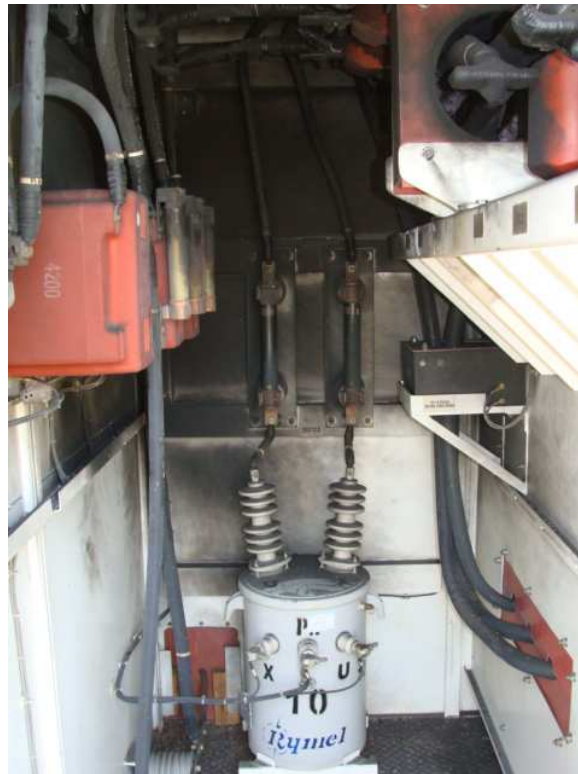
Figura 19. Efectos de la falla de un pararrayos en el cubículo de potencia
