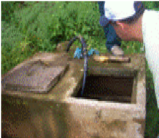
IMAGEN 5. Caja de Distribución
