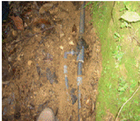
IMAGEN 4. Tubería con fugas
