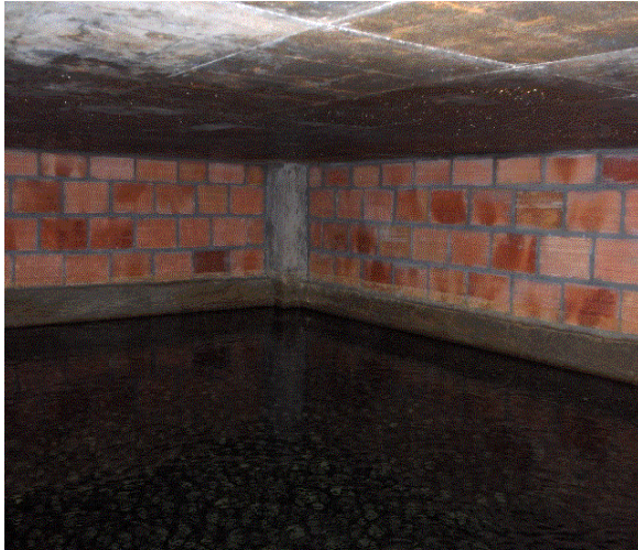
IMAGEN 22. Tanque de Lavado
