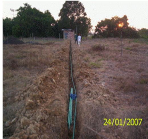
IMAGEN 30. TUBERIA DEL SISTEMA ELECTRICO
