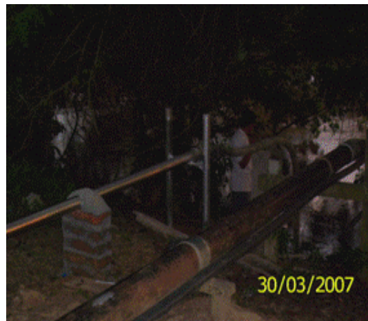
IMAGEN 28. ADUCCION A LAS BOMBAS
