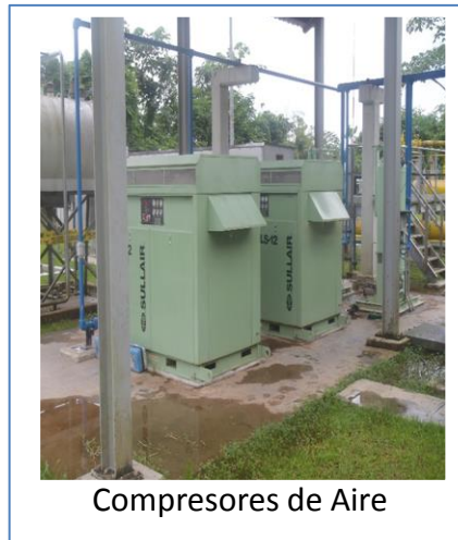
Figura 20. Facilidades de Locación C3
