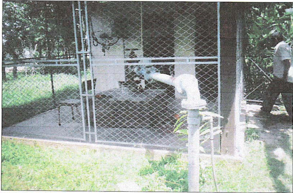
Caseta de bombeo, donde se encuentra el pozo perforado - Tubería de impulsión
