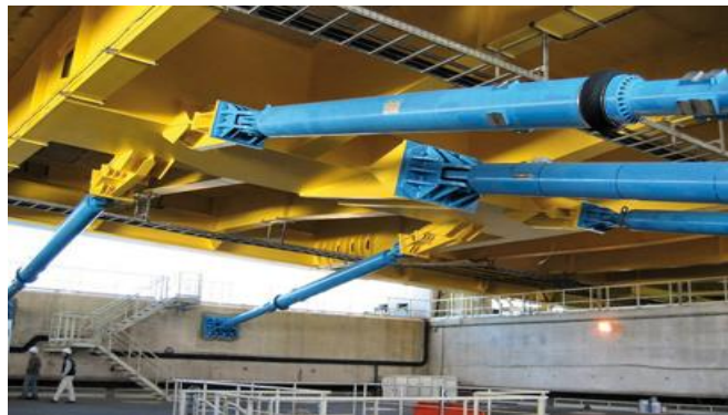
Figura 19. . Dispositivos de amortiguamiento de fluidos viscosos empleados en el puente Rion Antirion.
