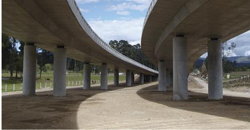
Figura 21. Aisladores de bajo amortiguamiento en Viaducto Portachuelo.
