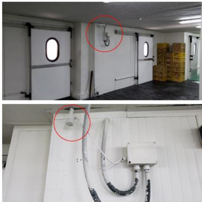
Figura 55. Instalación de PT-100 en antecámara.
