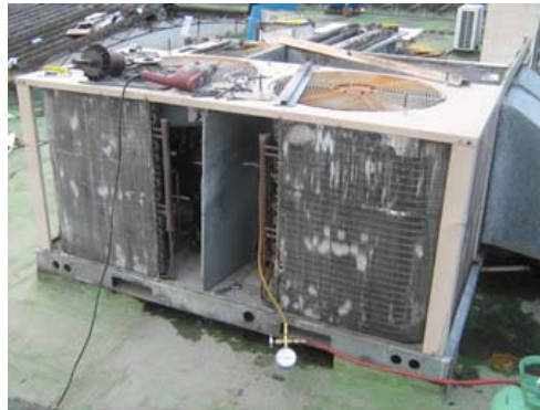
Figura 69. Recarga de refrigerante.
