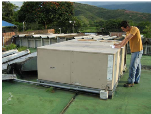
Figura 68. Aire acondicionado del laboratorio del CDT de GAS.
