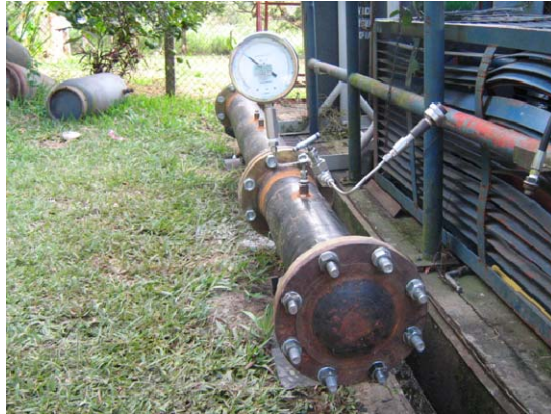
Figura 97. Manómetro y toma de presión.
