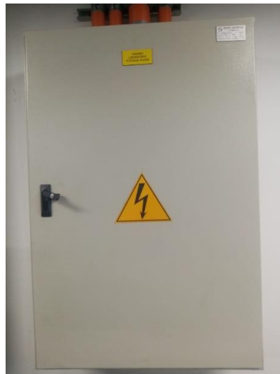
Ilustración 34 - Tablero eléctrico principal del laboratorio de potencia fluida.
