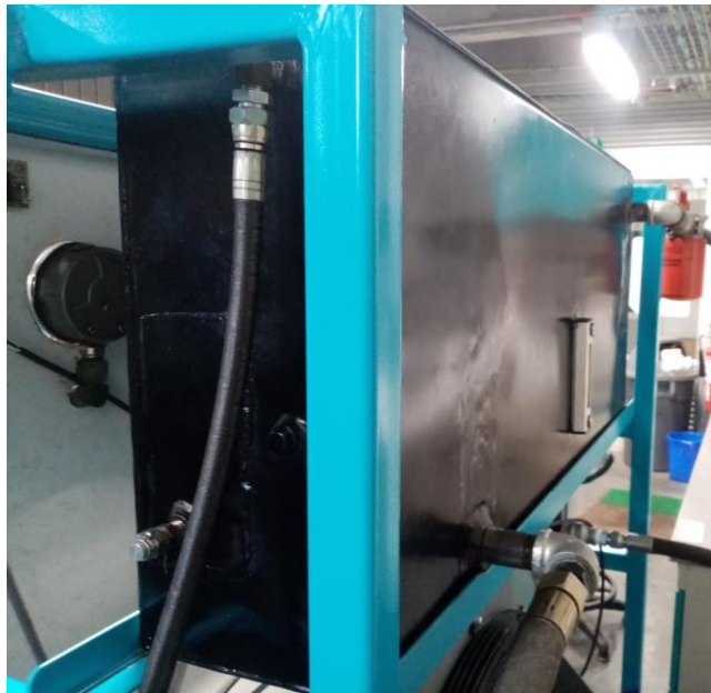
Ilustración 13 - Tanque del sistema.
