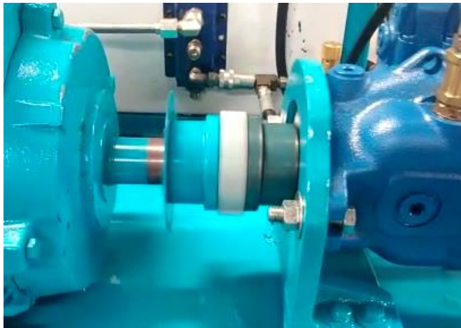
Ilustración 28 - Acople entre eje del motor y la bomba.
