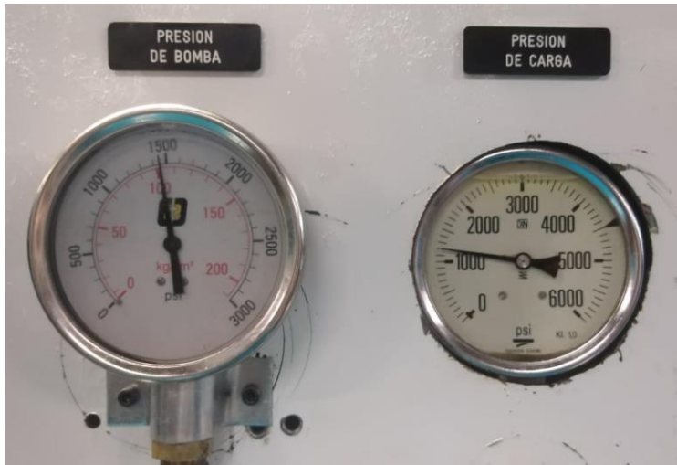
Anexo A - Manómetros de presiones de carga y de bomba en funcionamiento.
