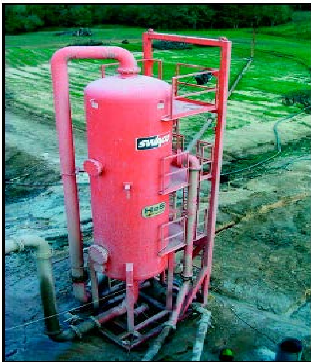
Figura 67. Separador de gas
