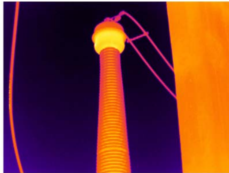
Figura 31. Termograma registrado correctamente.
