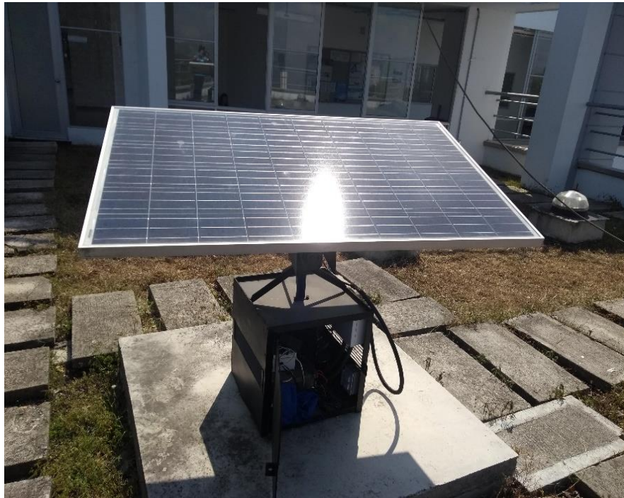
Figura 8. Seguidor solar ubicado en el 5° piso del Edificio de Ingeniería Eléctrica.
