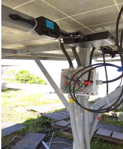
Figura 3. Microinversor Enphase M250 instalado en la terraza del Edificio de Ingeniería Eléctrica.
