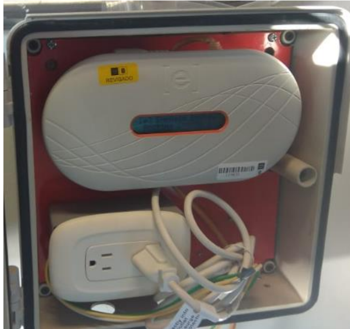
Figura 4. Envoy R de Enphase Energy instalado en el Edificio de Ingeniería Eléctrica.
