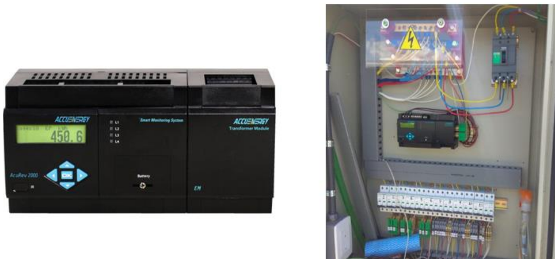
Figura 5. Medidor AcuRev de AccuEnergy instalado en los tableros eléctricos en la terraza del Edificio de Ingeniería Eléctrica.
