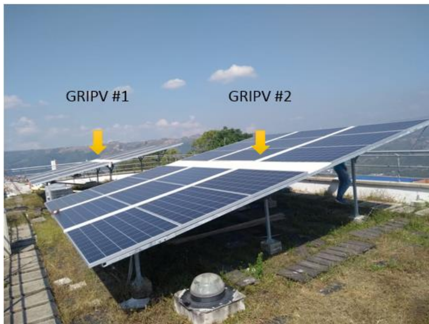
Figura 9. Sistemas GRIPV #1 y #2 del Edificio de Ingeniería Eléctrica.
