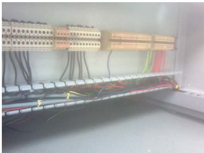
Figura 42. Borneras y canaletas
