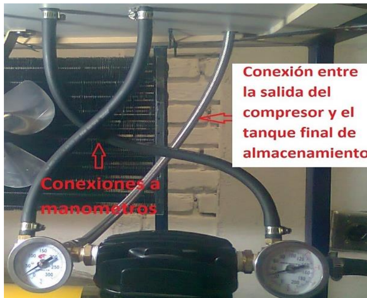
Figura 25. Conexiones de entrada y salida del compresor de segunda etapa.
