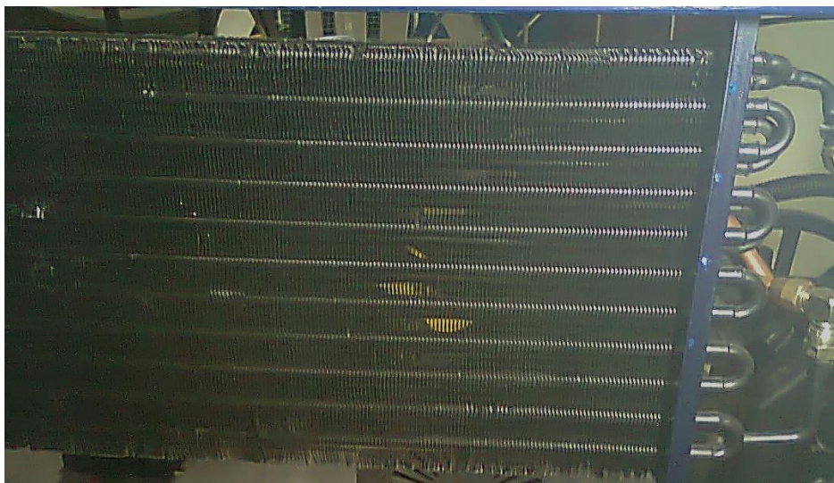
Figura 21. Radiador del sistema de interenfriamiento.
