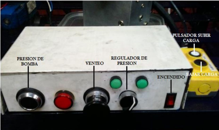
FIGURA 85. Tablero de Control.
