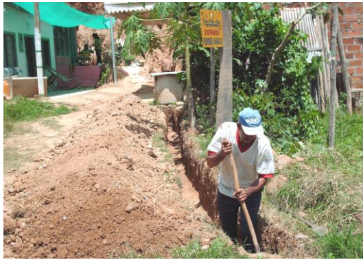
Foto 26. Adecuación doméstica de un sistema desagüe. Asentamiento Valle de los Caballeros. Fuente: el autor.
