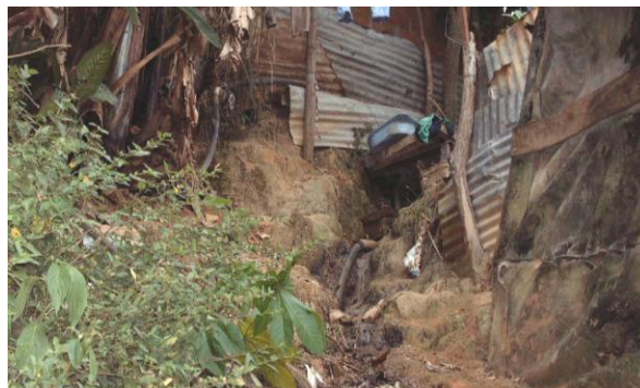
Foto 9. Viviendas construidas sobre laderas con filtraciones de agua. Asentamiento Pablón Villa Lina.
