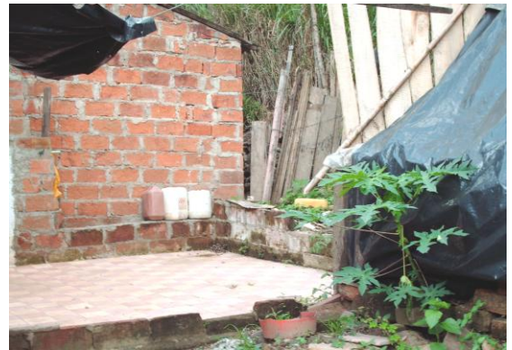
Foto 61. Vivienda destruida y abandonada a orillas del río de Oro. Asentamiento La Playita.
