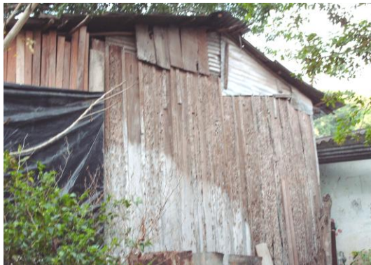
Foto 16. Vivienda de más de 15 años en el asentamiento La Playita. Fuente: El autor.
